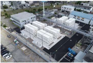
①ソーラ浜松蓄電所
