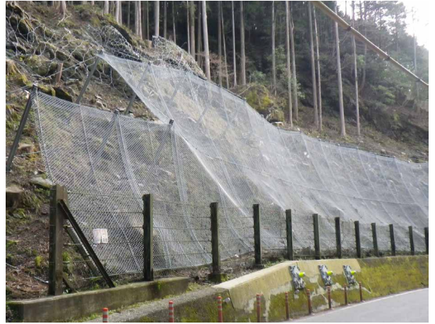
▲ 道路斜面对策
