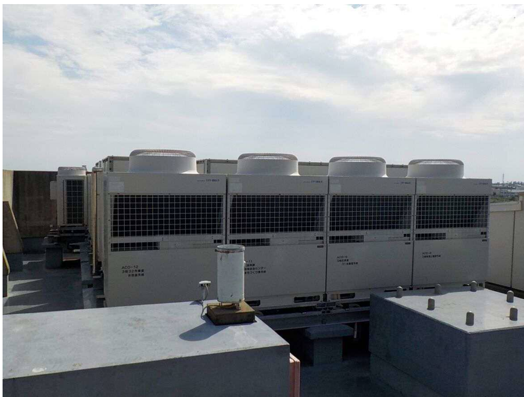
区役所庁舎屋上の空調設備(蓄熱槽・室外機)
