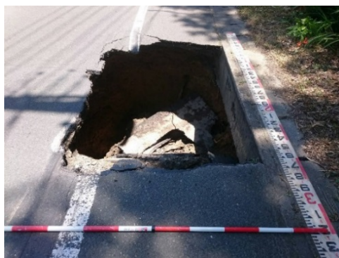
図1.7 浜松市での道路陥没の事例 (一般県道 横尾根洗線 平成29年7月)
