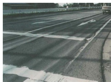
図1.5 わだち掘れ発生事例
