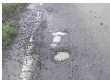
図1.4 ポットホール発生事例
