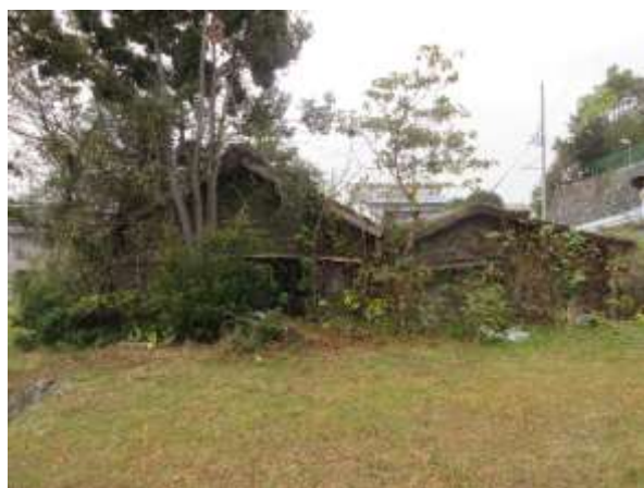
雑草・雑木の繁茂、東棟の西側への歪み
