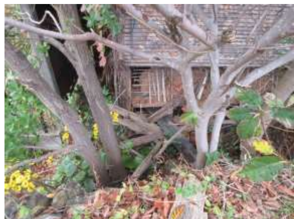
柱等の主要構造部の腐朽、外壁の脱落
