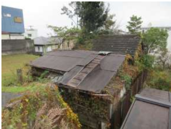
屋根材のめくれ
