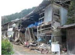
倒壊のおそれのある空き家
