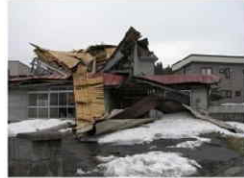
積雪により屋根が落下した空き家
