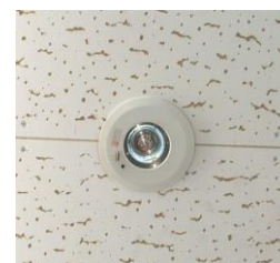
天井設置の非常用照明
