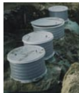
【合併処理浄化槽】
