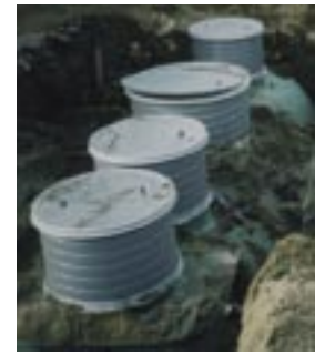
【合併処理浄化槽】
