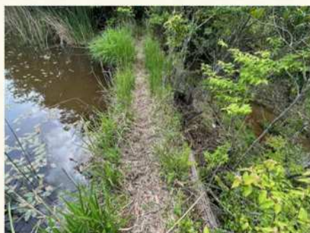
風化により決壊の危機にある堤体
