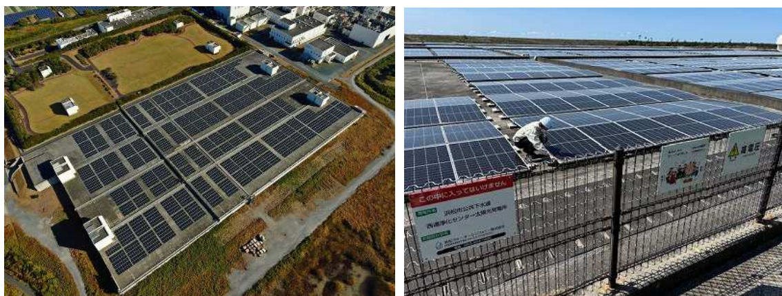
図 13 ソーラーパネル設置状況（水処理棟）
