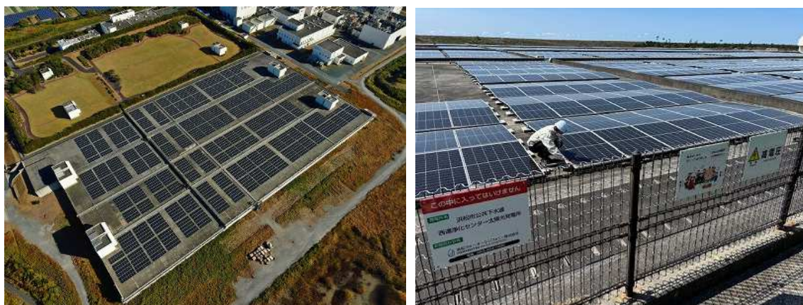
図 13 ソーラーパネル設置状況（水処理棟）
