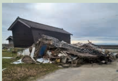
能登半島地震で倒壊した家屋
