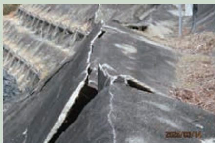
処分場内ののり面地すべり被害
