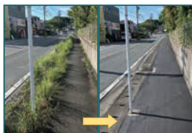
縁石周辺部に繁茂する雑草と除草作業後の歩道(池川富塚線・中央区)
