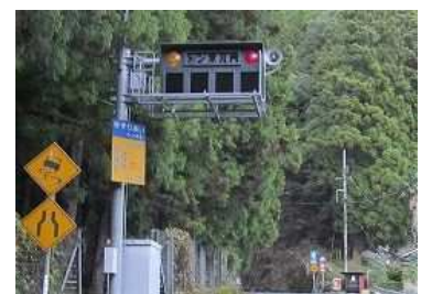
写真 3-3 非常警報用設備 （小石間隧道）
