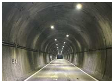
写真 3-2 照明設備（LED） （大瀬隧道）
