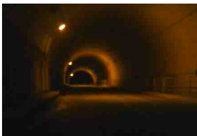
写真 3-1 照明設備（低圧 Na 灯） （阿多古トンネル）
