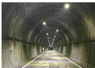
写真 3-2 照明設備（LED） （大瀬隧道）
