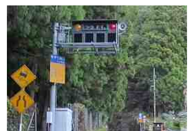
写真 3-3 非常警報用設備 （小石間隧道）
