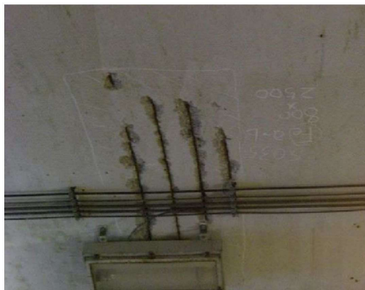
写真-2 鋼材腐食の例
