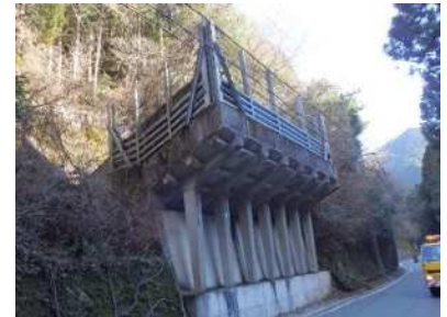
写真 2-3 落石防護柵 (国道 152 号シェッド 1)
