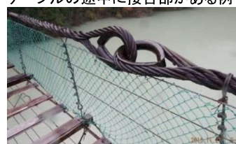
ケーブルの途中に接合部がある例
