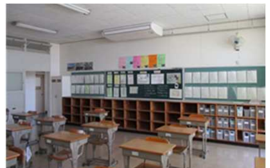
市立小中学校空調設備
