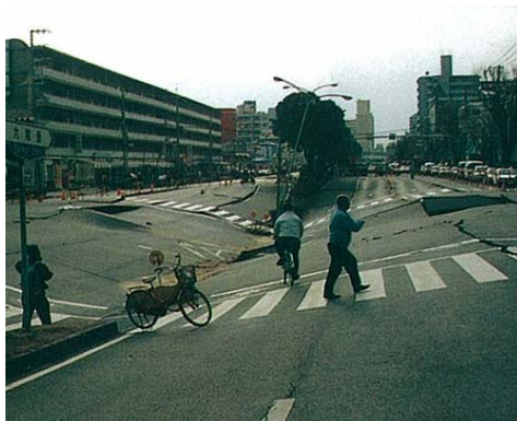
道路の沈下による被害例
