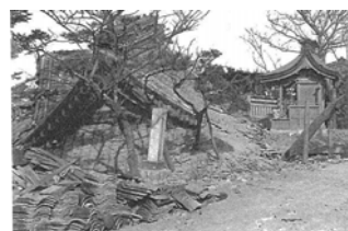
東南海地震における六所神社社殿の倒壊(中野町)
