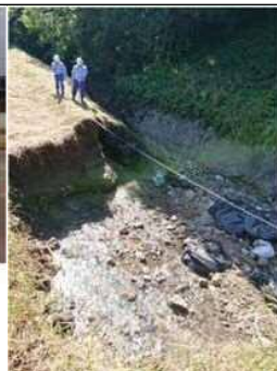
宮城県岩沼市志賀沢川 被災状況調査
