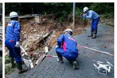
岩手県宮古市崎山付近 被災状況調査
