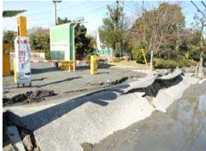
震災直後の総合体育館出入口 付近
