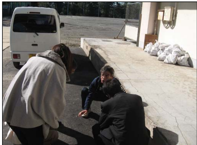
液状化により校舎の周りが 下がり復旧工事が完了した箇 所 (正面：成田校長先生)
