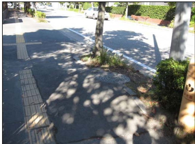
(10) 復旧した見明川小学校 前の歩道(マンホールは盛上 っている)
