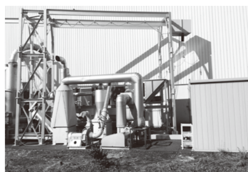
バイオマス燃料化プラント
