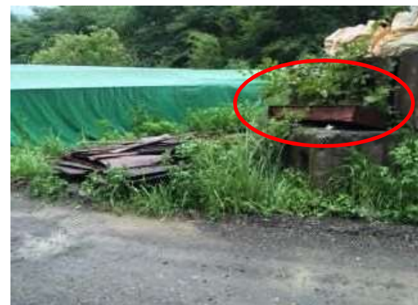
明細表⑰ 令和4年度道路メンテナンス国庫補助事業(市)佐久 間芋堀1号線イマイチバ橋橋梁修繕工事
