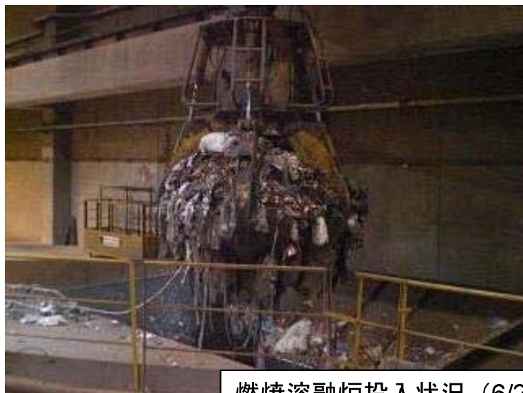
燃焼溶融炉投入状況 (6/25)
