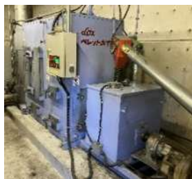
木質ペレットボイラー
