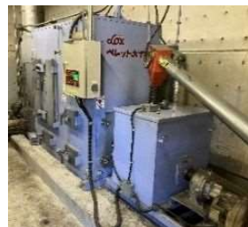
木質ペレットボイラー
