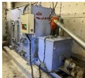
木質ペレットボイラー
