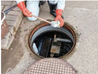
合併処理浄化槽の保守点検
