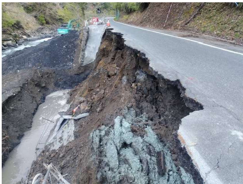
路肩崩壊状況
