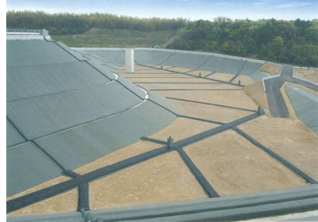
法面ガス抜き管
