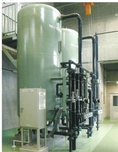
活性炭吸着塔
