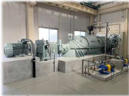
第2排水機場 ポンプ設備
