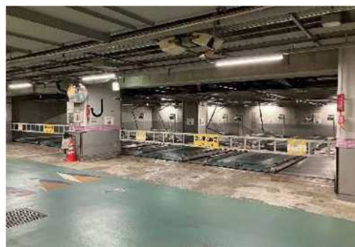
＜地下2階機械式駐車場＞
