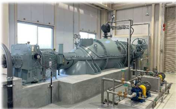
第2排水機場 ポンプ設備
