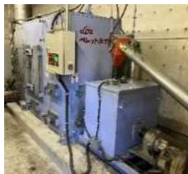
木質ペレットボイラー
