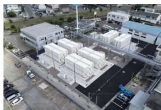
①ソーラ浜松蓄電所
