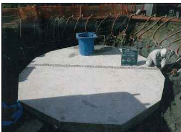
図 耐震性貯水槽
