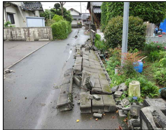
図 ブロック塀の倒壊例
