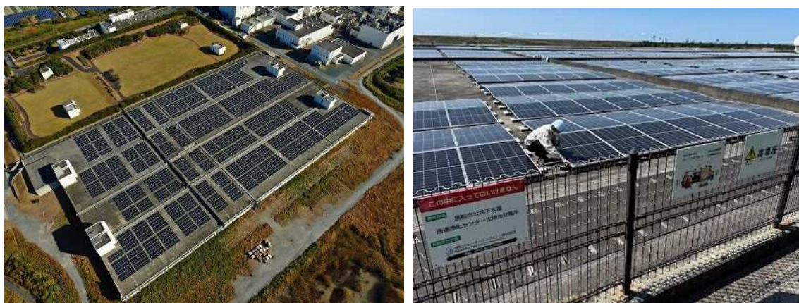
図 13 ソーラーパネル設置状況（水処理棟）
