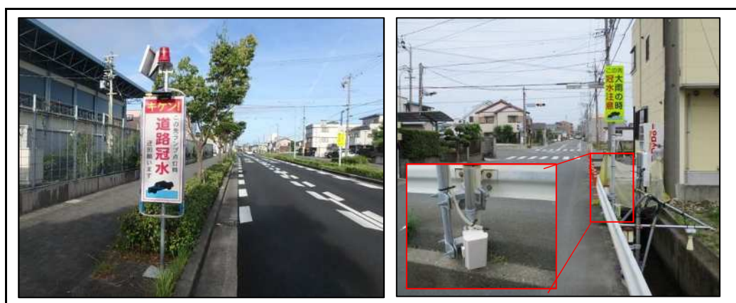
図 道路冠水情報システム
