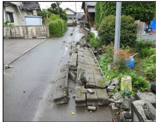
図 ブロック塀の倒壊例
