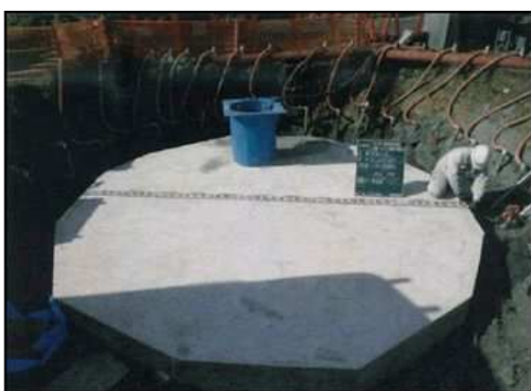
図 耐震性貯水槽
