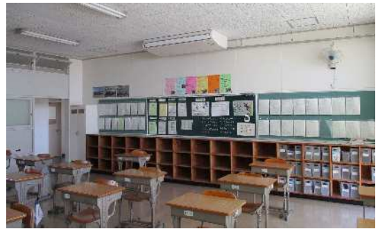
市立小中学校（普通教室）空調設備
