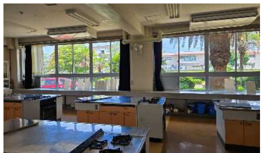
市立小中学校（特別教室）空調設備
