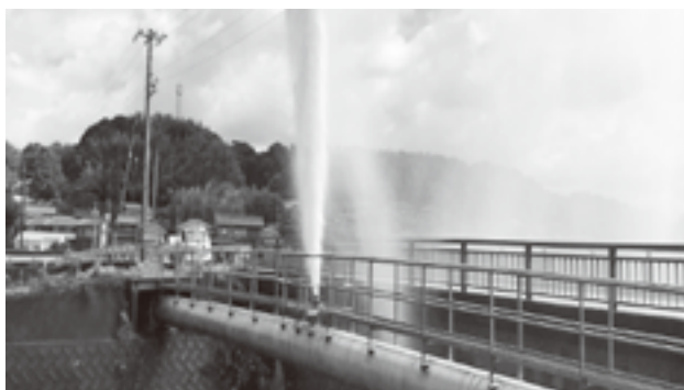
2023（令和5）年度に発生した、水管橋の空気弁の老朽化が原因の漏水（中央区伊左地町）
