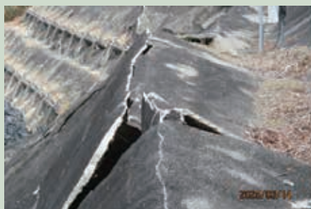
処分場内ののり面地すべり被害
