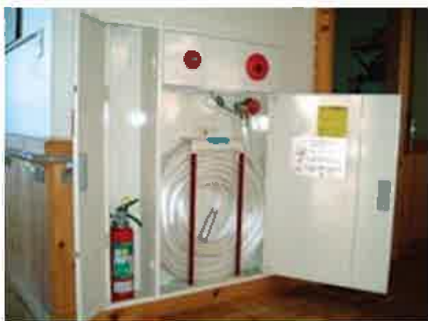
消火器、屋内消火栓
