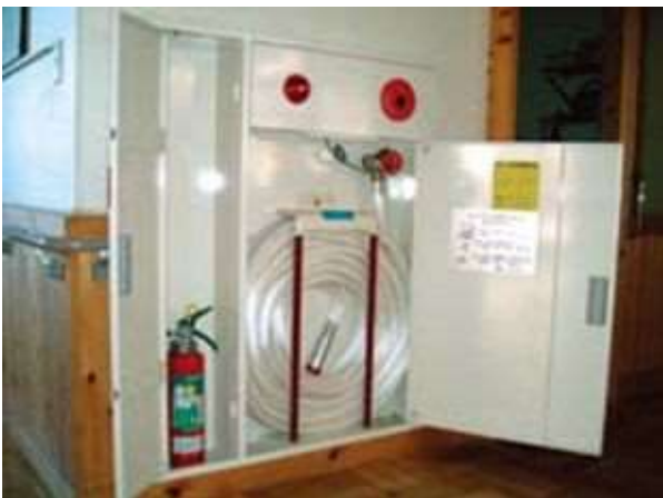
消火器、屋内消火栓
