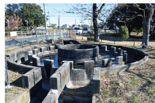
三方原水13号分水工(円筒分水)
