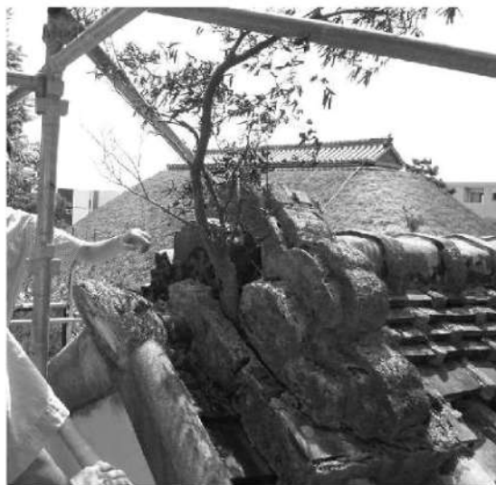
土蔵屋根瓦の様子
