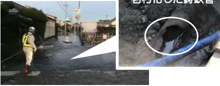
水道管路の老朽化に起因する漏水（2024年度）【中央区東若林町】
