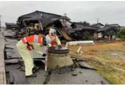
令和6年能登半島地震の影響で浮上したマンホール【石川県珠洲市】
